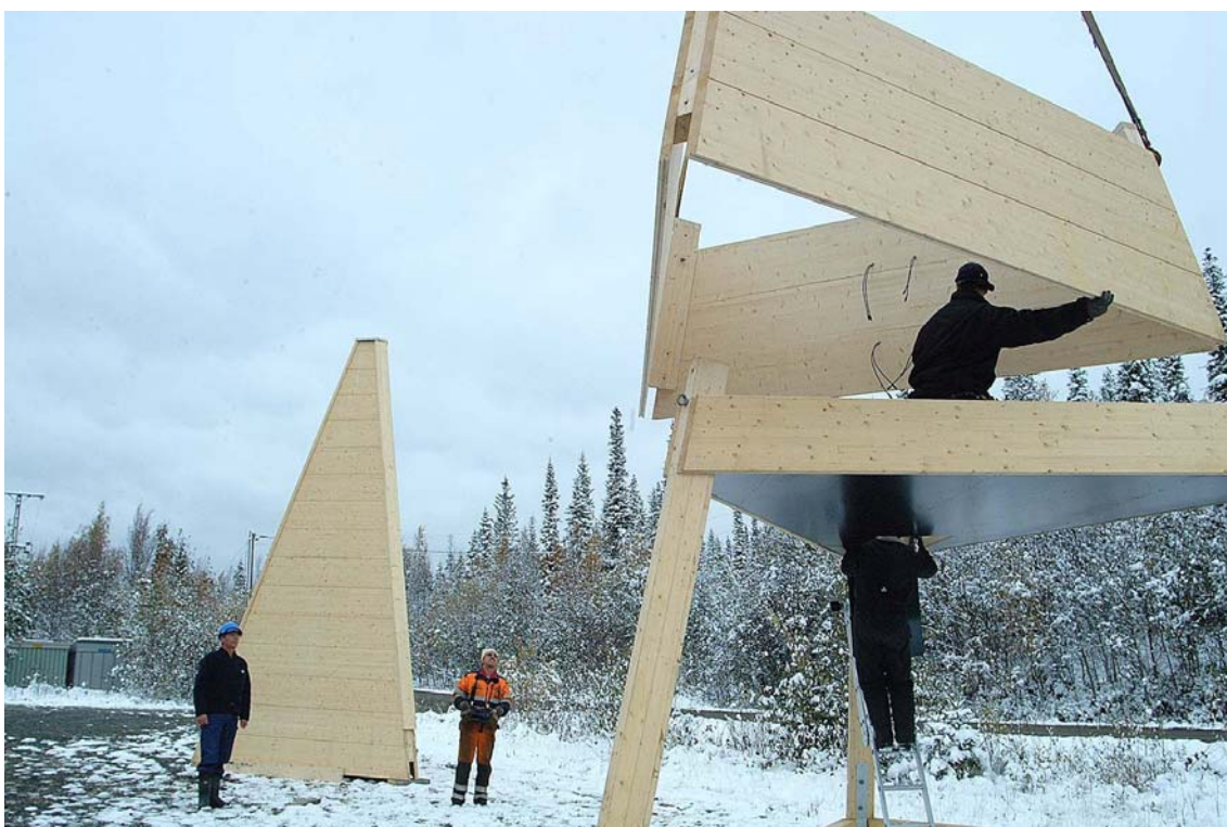
En försöksverksamhet pågår med miljövänliga radiomaster i Jämtlandsfjällen. Det är företaget Westél som bygger masterna i limträ, och just denna ska sättas upp på Sällsjöfjällets topp. Tekniken är inbyggd i mittenpartiet medan nederdelen är öppen för att inte bjuda motstånd mot snö och vindar. Masterna är avsedda för radiotelefoni.
